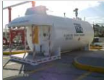
Almacenamiento de Etanol
